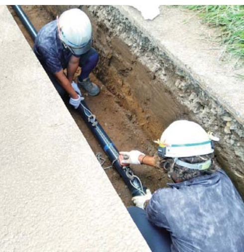
RRロング継手管(φ100)の新設工事 設計・施工の両面で、RRロング継手管の採用が、施工性の向上に大きく貢献している。また、更新に合わせた配水管のタンクサイジングも積極的に進めておられる。
